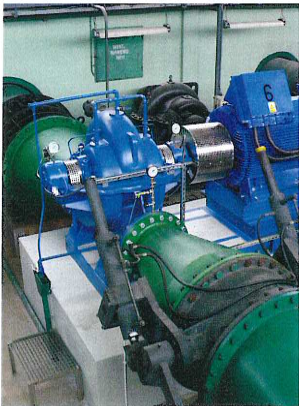
FOT. 2 Przewidziano już kolejne modernizacje w przepompowniach w Paprocanach i Urbanowicach
