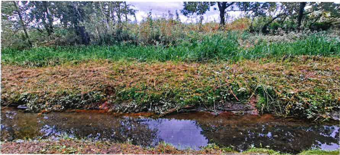
Zdjęcie nr 2.2. Widok na skarpe zachodnią od strony ul. J. Brzechwy.
