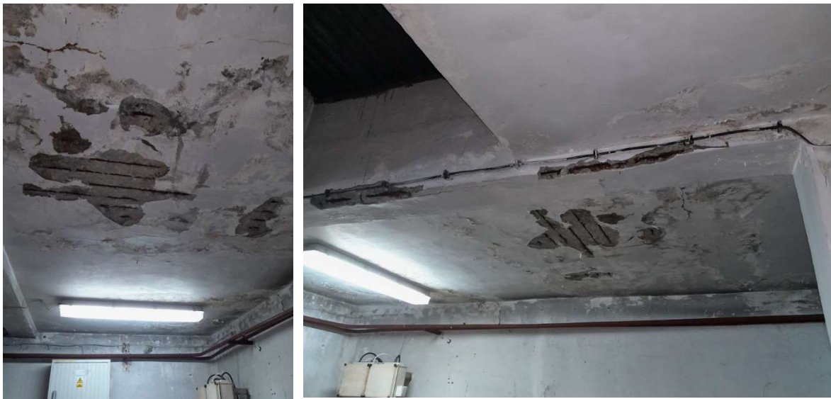
fot 2 i 3 Powierzchniowe uszkodzenia sufitu budynku w poziomie_0.
