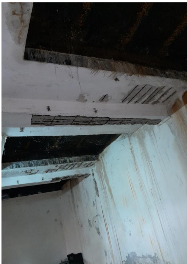
fot 5. Strop nad komorami aparatów przeciwuderzeniowych (podziemie)
