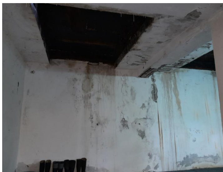
fot 3. Strop nad komorami aparatów przeciwuderzeniowych (podziemie)
